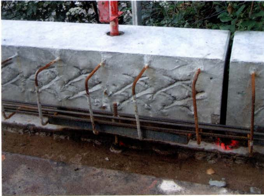
Figure 66. Élément de corniche maintenu par un fer U fixé par une tige scellée dans le tablier
