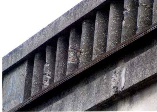
Figure 83. Nombreux éclats de béton avec fers apparents sur les colonnes
