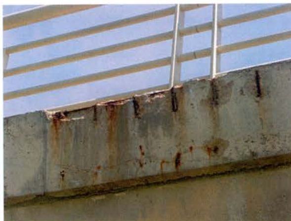
Figure 33. Taches de rouille en surface du parement
