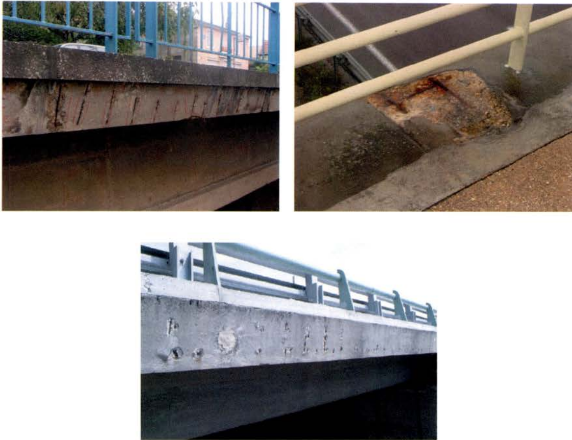
Figure 22. Présence d'éclats avec armatures apparentes en parement de corniche
