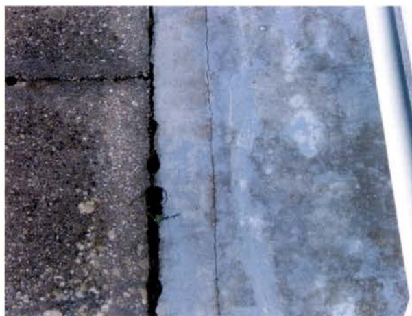
Figure 41. Reprise de bétonnage fissurée
