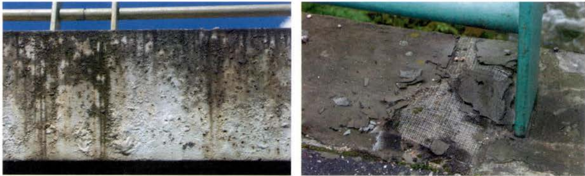
Figure 36. Décollement du revêtement sur des corniches
