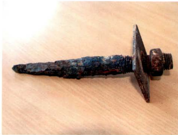
Figure 60. Tige d'ancrage totalement sectionnée au niveau de l'interface corniche / tablier
