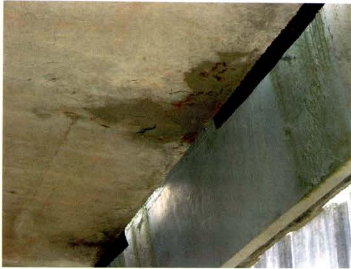
Figure 73. Ruissellement sous l'encorbellement
