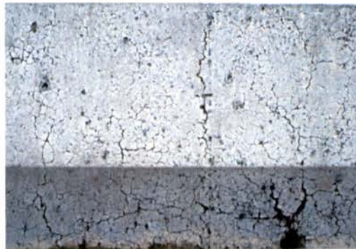
Figure 20. Fissuration caractéristique d'une réaction de gonflement interne
