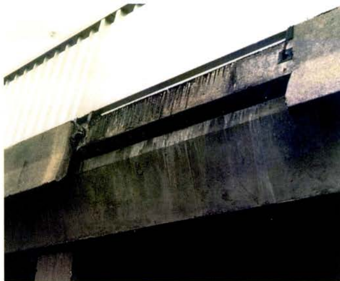
Figure 16. Chute d'un élément de corniche par rupture de la liaison
