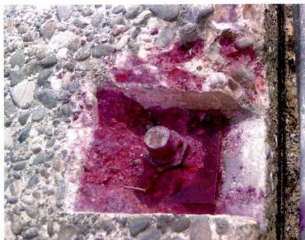
Figure 52. Tige filetée de maintien par boulon de la corniche sur le tablier, après enlèvement du mortier de cachetage et vérification de la carbonatation du béton par pulvérisation d'un indicateur coloré (phénolphtaléine).
