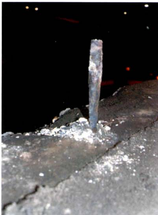
Figure 59. Vestige d'une tige d'ancrage encore en place sur le tablier après enlèvement de la corniche avec diminution de la section au niveau de l'interface corniche / tablier.
