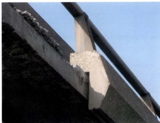
Figure 11. Chute d'un élément de corniche
