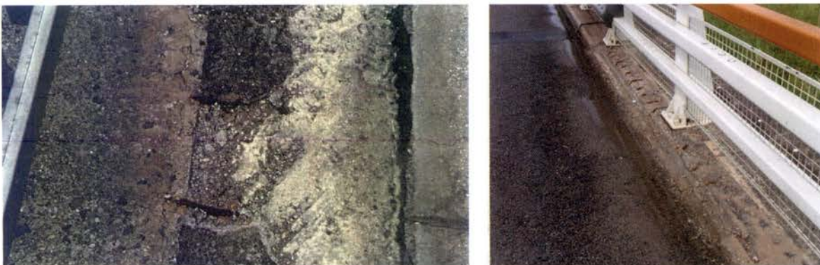
Figure 39. Corrosion de l'armature de liaison en partie supérieure
