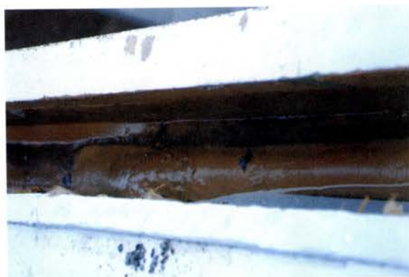
Figure 80 b. Gonfles sous la chape d'étanchéité
