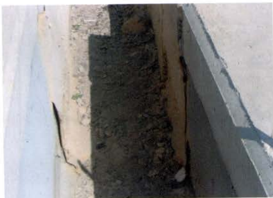
Figure 80 a. Chape d'étanchéité décollée et déchirée
