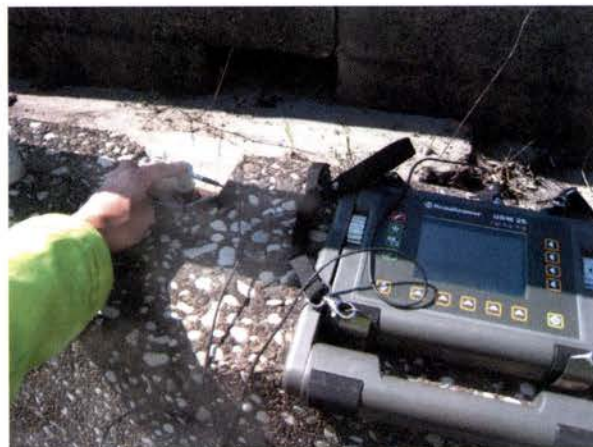
Figure 51. Mesure ultra sonore pour la détection de défauts sur les liaisons métalliques corniche /tablier
