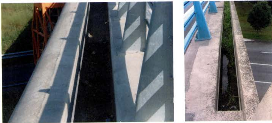
Figure 79. Dépôts et végétation dans une corniche caniveau
