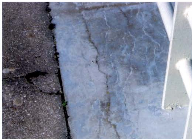
Figure 25. Exemple de fissure longitudinale
