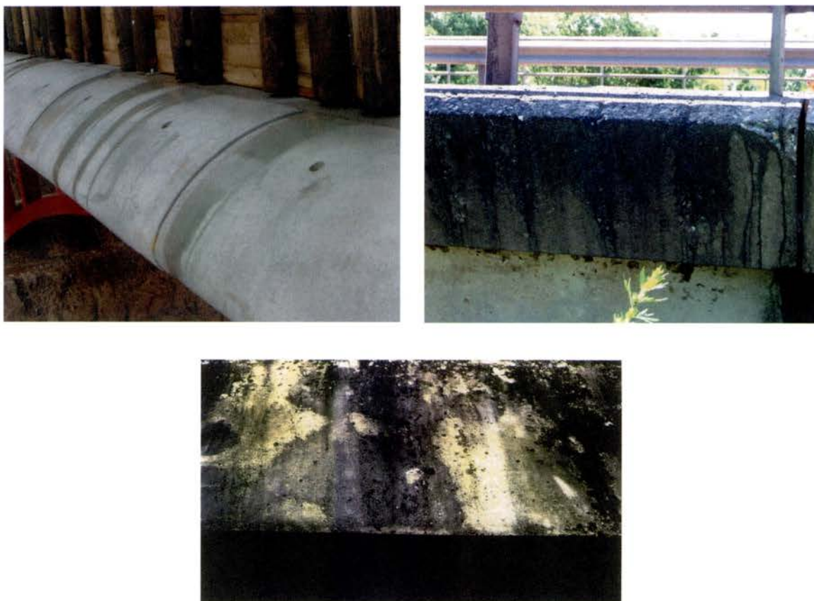
Figure 28. Différents aspects du parement liés aux écoulements et aux salissures
