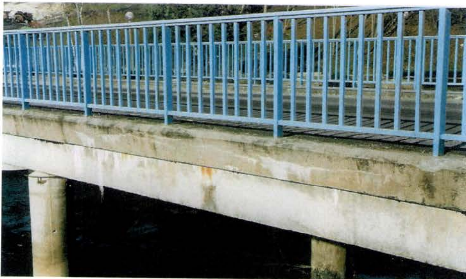
Figure 8. Corniche fissurée avec coulures de calcite résultant de l'absence du relevé d'étanchéité
