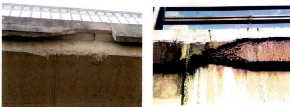
Figure 21. Éclats de béton sans armature apparente
