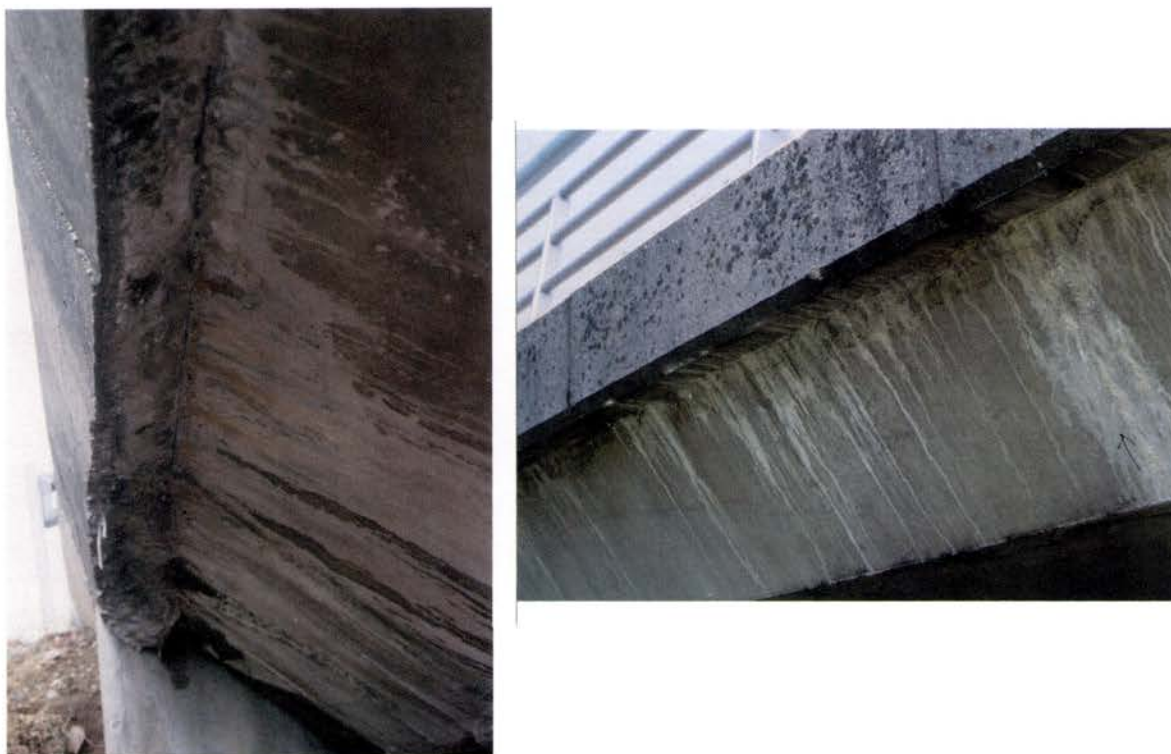
Figure 48. Coulures à l'interface corniche - tablier
