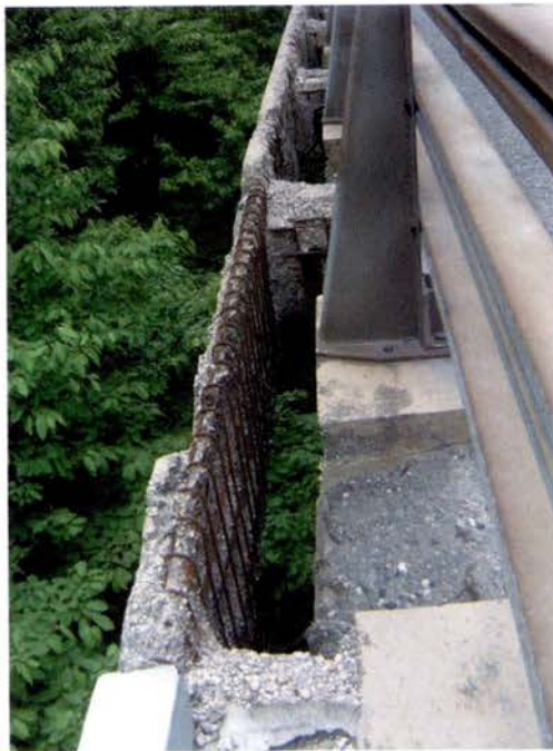
Figure 72. Dégradation très avancée d'une corniche
