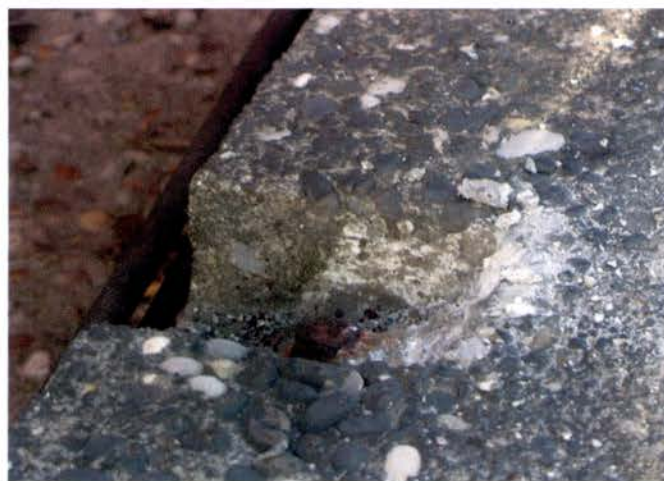
Figure 12. Réserve et trou où étaient placés la tige filetée et son écrou.
