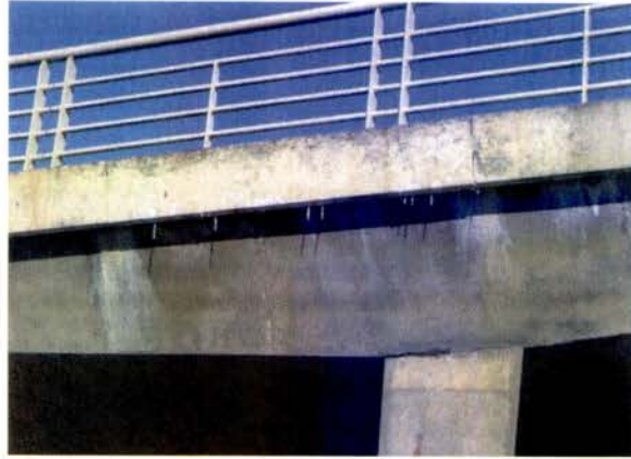
Figure 42. Bavette de calcite sur la face latérale du tablier révélant une reprise de bétonnage fissurée
