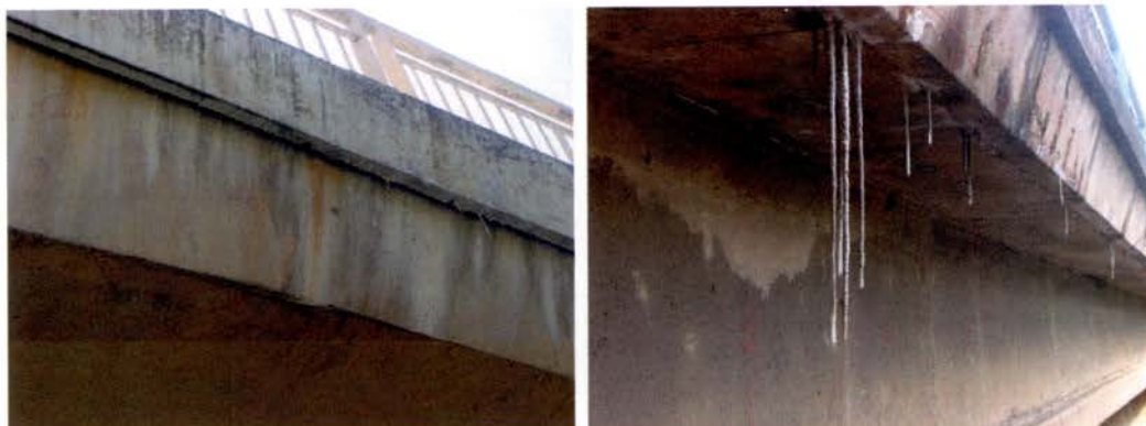
Figure 40. Écoulement couleur rouille et stalactites sous les corniches
