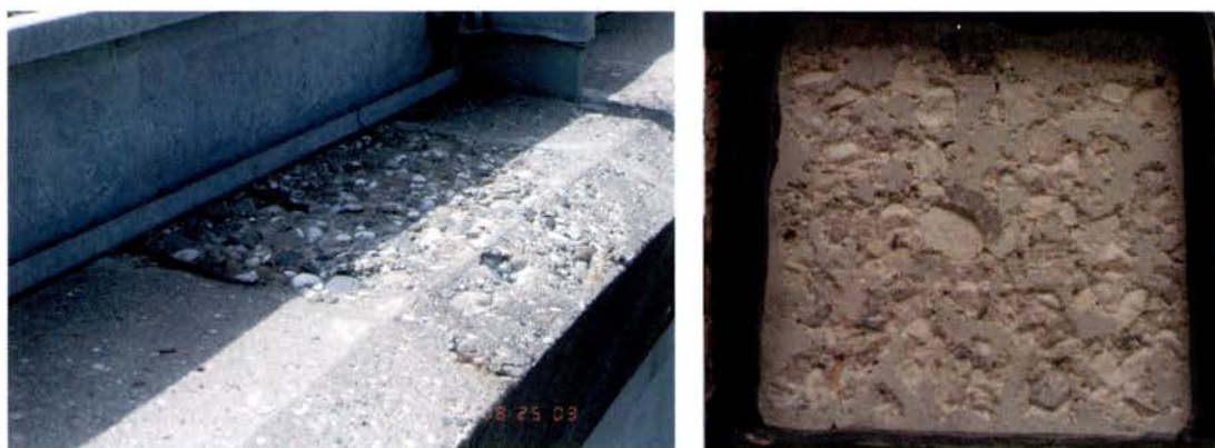
Figure 32. Exemple d'écaillage sur corniche et sur éprouvette de laboratoire
