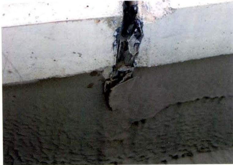
Figure 81. Étanchéité déchirée au droit du joint de dilatation
