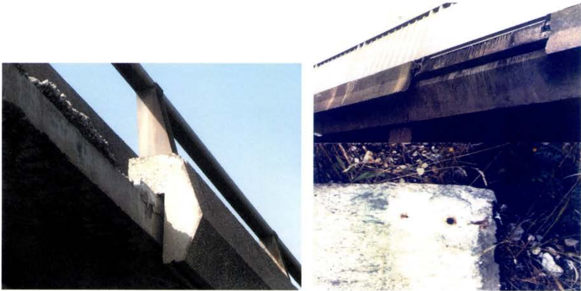
Figure 44. Chute d'un élément de corniche
