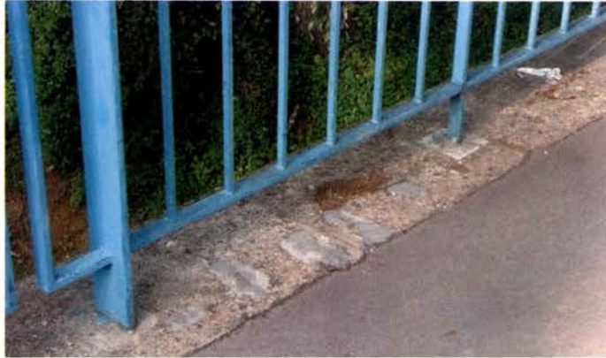
Figure 38. Décollement des ragréages
