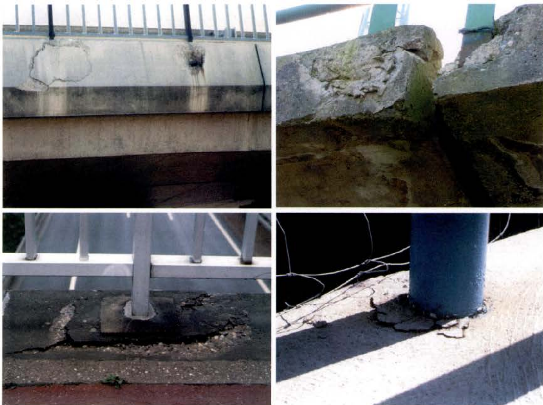
Figure 23. Dégradations sur les différentes faces de la corniche
