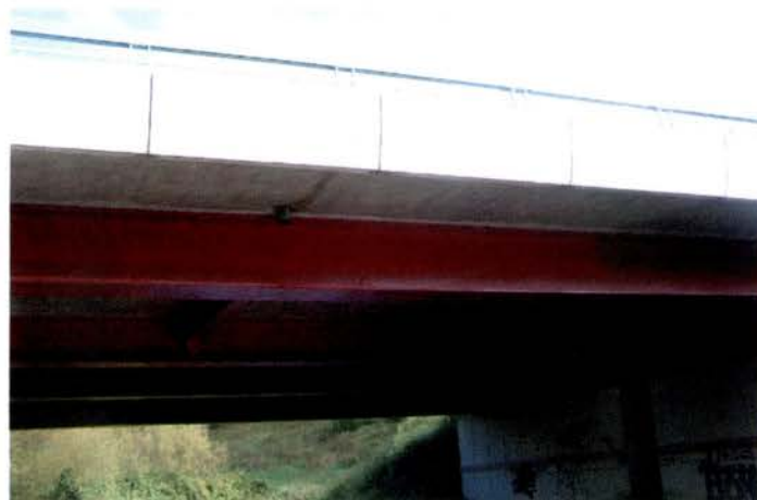
Figure 4. Joints entre éléments de corniche non traités
