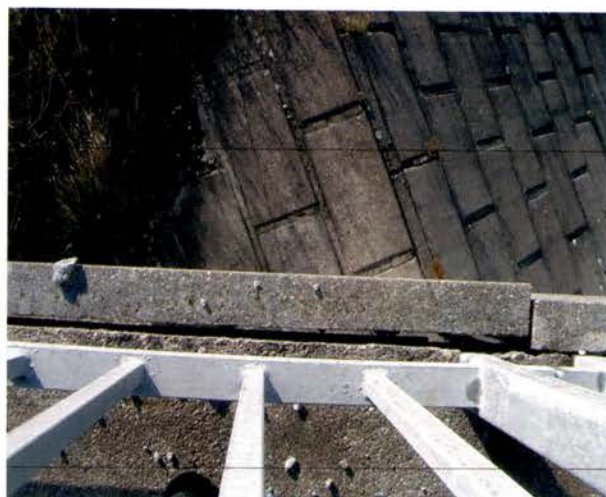
Vue du dessus : décalage entre corniche et tablier
