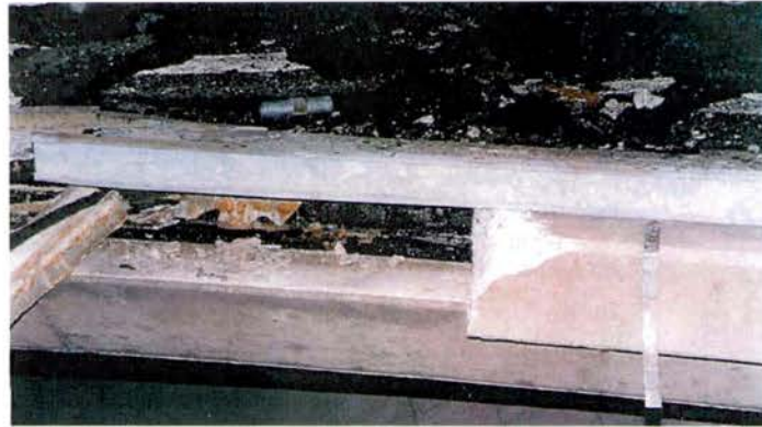
Figure 3. Après dépose de la corniche, constatation de l'absence de liaison
