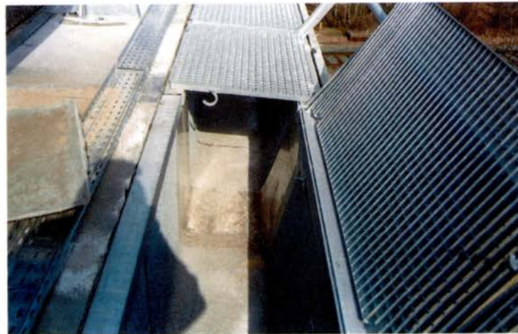
Figure 82. Grille sur corniche caniveau assurant la fonction de garde corps de service
