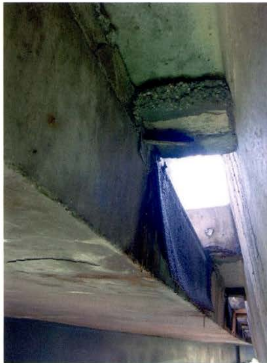
Figure 74. Dégradation et contournement de la bavette
