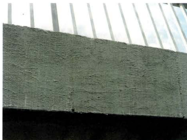
Figure 63. Revêtement organique sur une corniche
