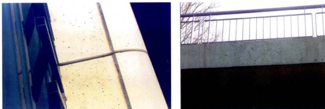
Figure 30. Aspect d'une corniche présentant du bullage
