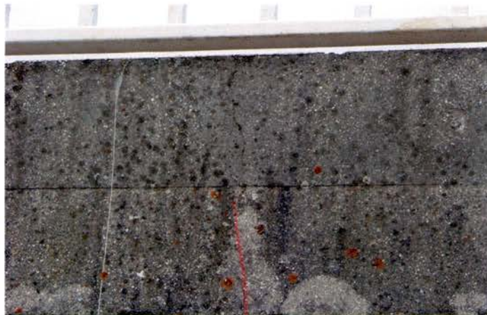
Figure 24. Exemple de fissure verticale
