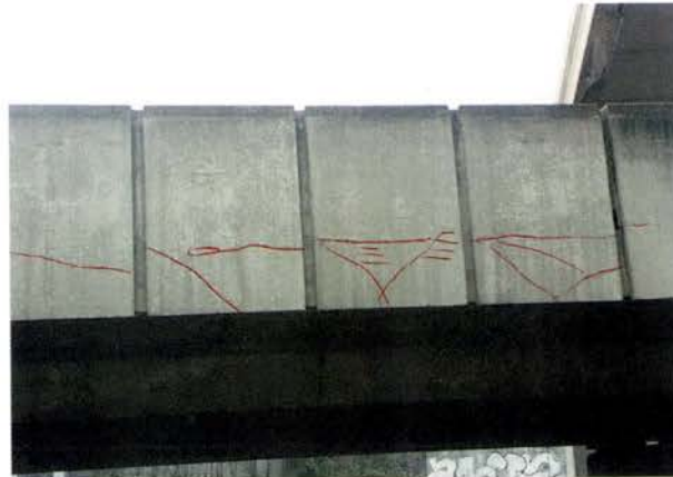
Figure 84. Fissuration due aux conséquences d'un changement de section brusque (de la partie horizontale permettant l'ancrage au tablier)
