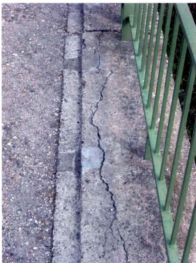
Figure 10. Fissure initiée suivant le tracé des liaisons
