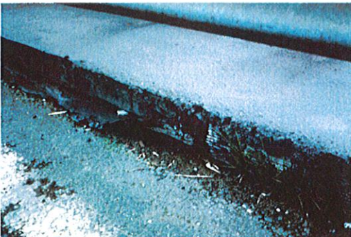
Figure 91. Relevé d'étanchéité non protégé et dégradé
