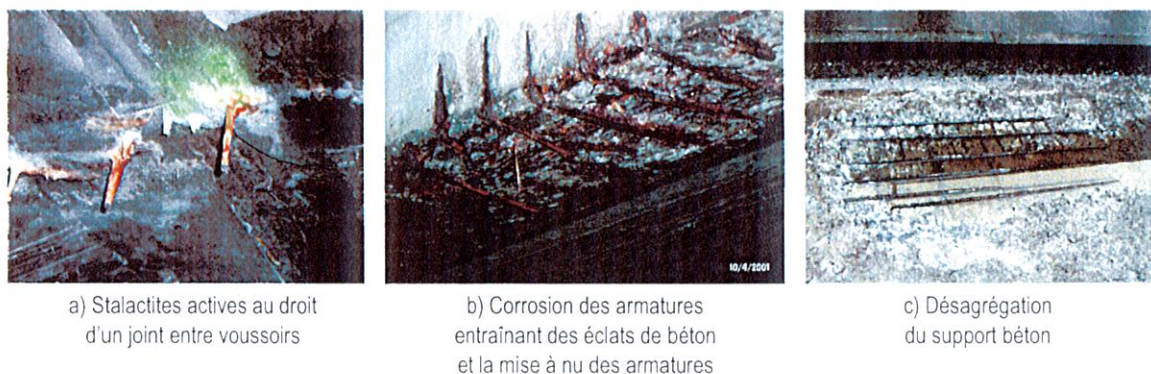
Figure 23. Altérations du béton armé dues à une défaillance de l'étanchéité
