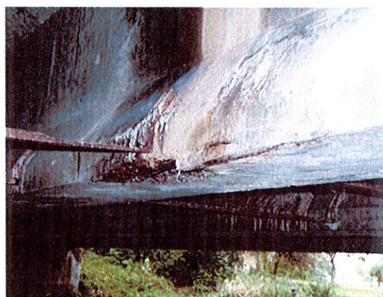
b) Ruissellement le long de l'âme d'une poutre
