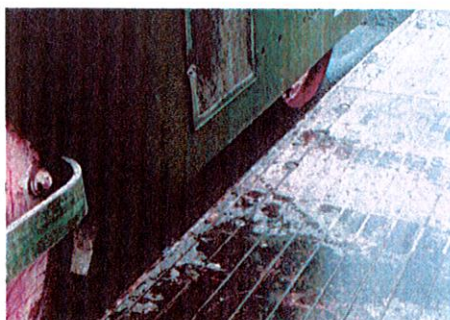
Figure 87. Exemple de compactage parallèlement à l'arête du joint afin d'éviter la formation du bourrelet à ce niveau
