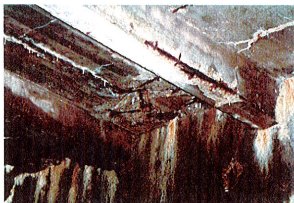
Figure 21. Exemple d'ouvrages sans étanchéité, conséquences en intrados
