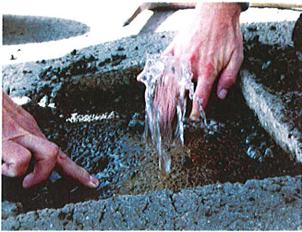
a) présence d'eau sous l'étanchéité
