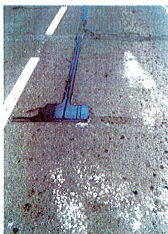
Figure 47. Remontée de bitume
