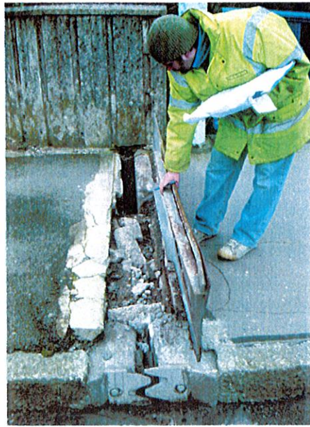
Figure 32. Joint de trottoir, absence du joint de surface et du joint de structure
