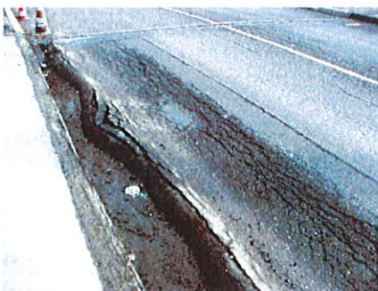
Figure 51. Fluage de l'asphalte
