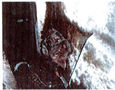
a) Ruissellement sur un capot d'ancrage de précontrainte en l'absence de cachetage de protection
