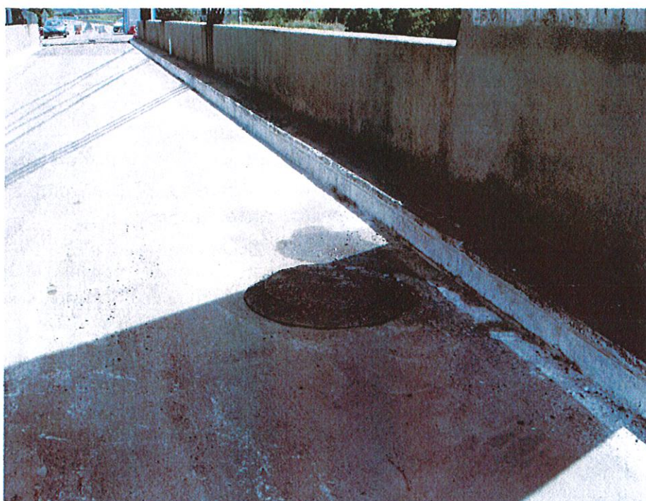
Figure 101. Accès à une chambre de minage découvert lors de l'enlèvement des enrobés
