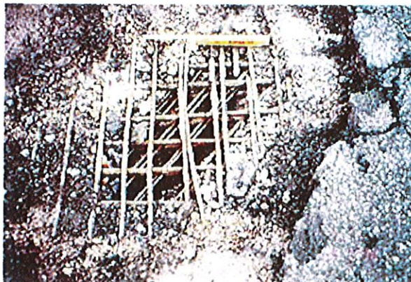
Figure 26. Phénomène de « pourrissement des dalles de tablier de pont » observé sur plusieurs ouvrages en Belgique (source (1) : BLPC n° 232 – Mai / juin 2001)
