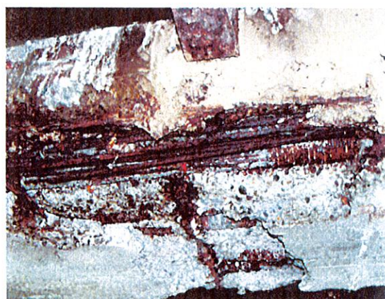
c) Corrosion des fils de précontrainte
