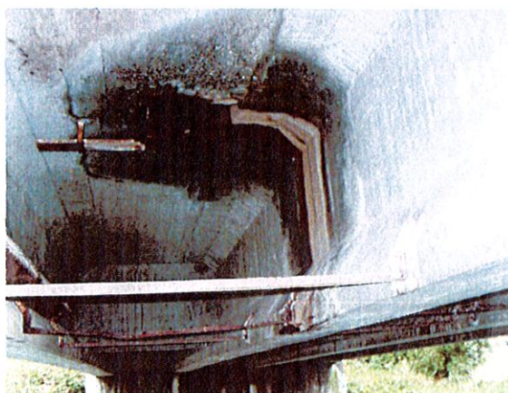
a) Infiltration d'eau en intrados de tablier
