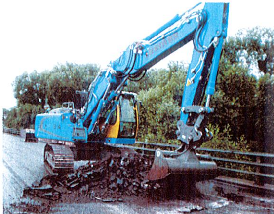
Figure 104. Vue de la pelle utilisée pour la dépose d'un complexe FPA après le rabotage de la couche de roulement
