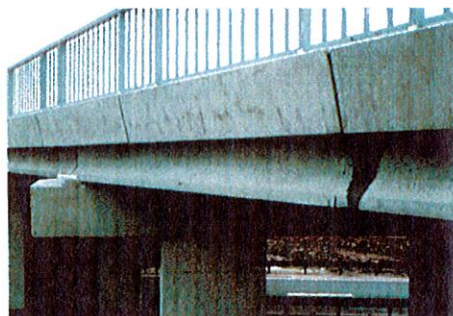
Figure 34. Fuites entre éléments préfabriqués de corniches
