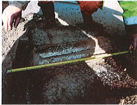
Figure 70. Fenêtre de reconnaissance - Confirmation de présence d'eau sous la chape d'étanchéité dans le reprofilage
