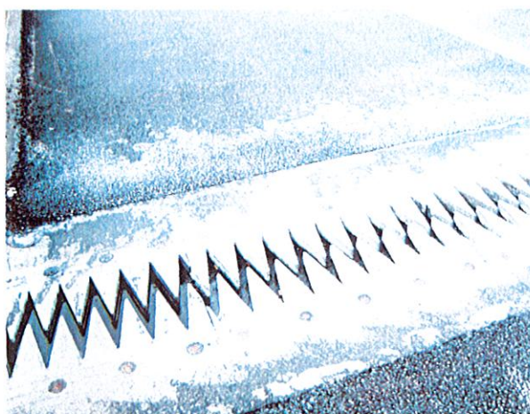
Figure 31. Remontée d'eau en surface au droit d'un joint de chaussée
