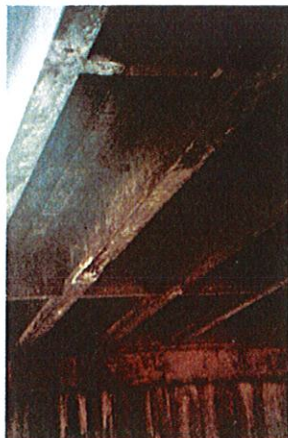
Figure 22. Absence d'étanchéité sous trottoir, cas des poutres de rive d'un VIPP
