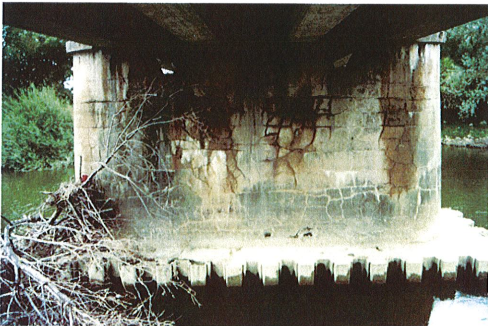
Figure 25. Développement d'une réaction de gonflement interne favorisé par un défaut d'étanchéité du tablier
