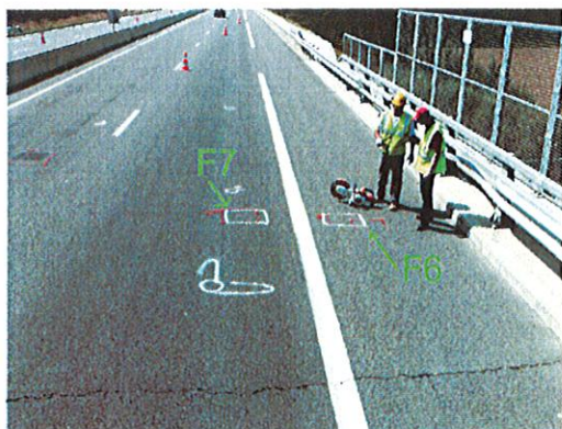
Figure 161. Vue de la voie lente et de l'emplacement des fenêtres F6 (zone hétérogène) et F7 (zone homogène) (épaisseur d'enrobé : 8 cm)
