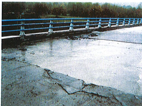
Figure 111. Déflachage en mortier hydraulique : décollement du mortier lors de la mise en œuvre par temps froid de la couche d'asphalte d'un système FPA
