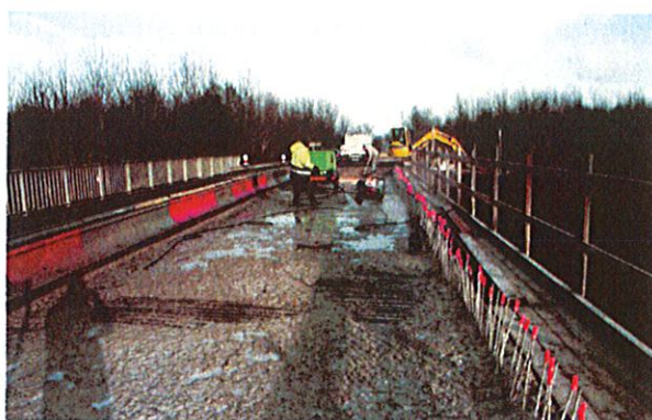
Figure 110. Support dégradé nécessitant un reprofilage général
