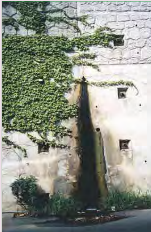
f. Dispositif de drainage mal adapté : importantes venues d'eau avec stagnation au pied de l'ouvrage. Végétation importante gênant l'examen visuel.
