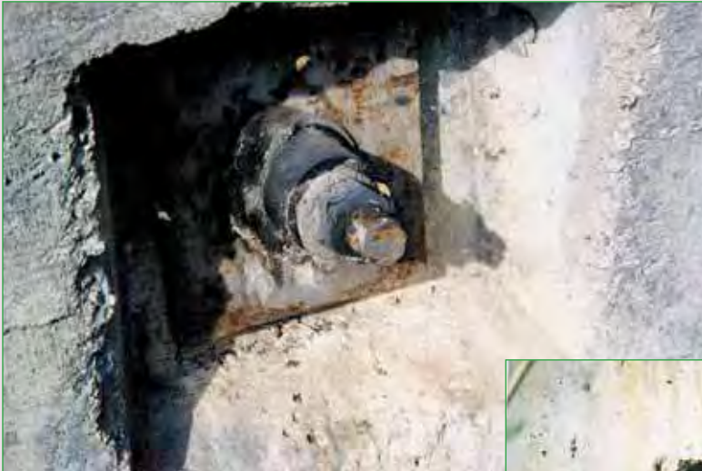
a. Vue d'une tête de tirant : barre, protection de la tête d'ancrage par capot plastique et graisse anticorrosive.
