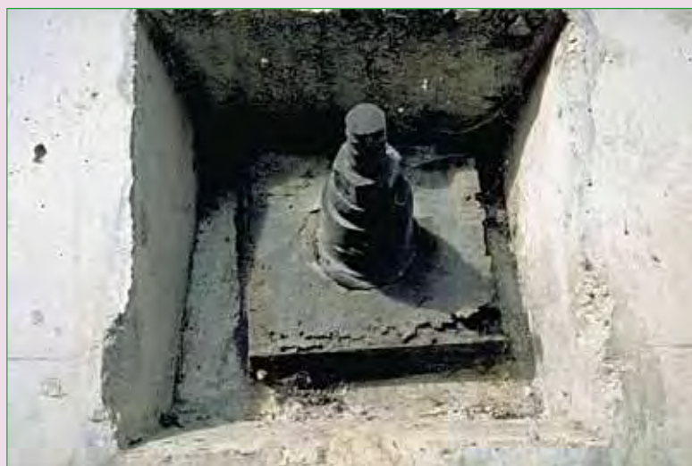
c. Sur la plaque d'appui, une pellicule superficielle est corrodée.
