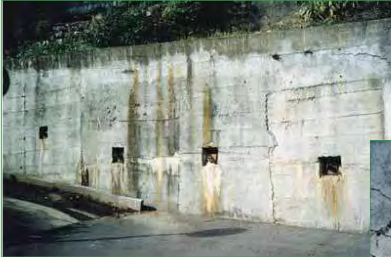
d. Désordres dus à des venues d'eau : concrétions au niveau des têtes de tirants, des fissures, taches d'humidité.
