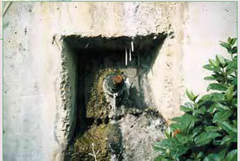
b. Venues d'eau au niveau de la tête du tirant.
