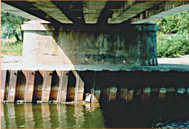
FIGURE 9 - Défaut de verticalité des palplanches lié à une mauvaise exécution.
