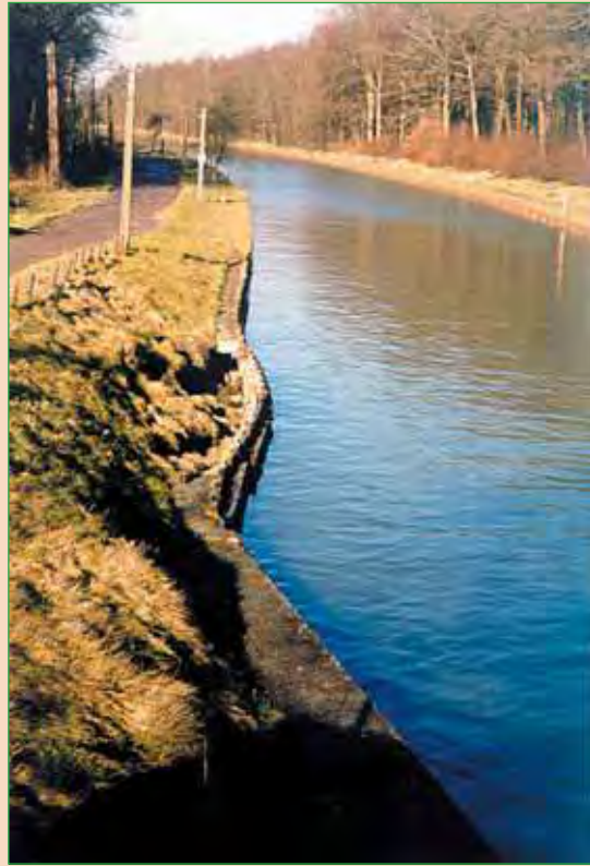
a. Déformation consécutive à une rupture de tirant.
