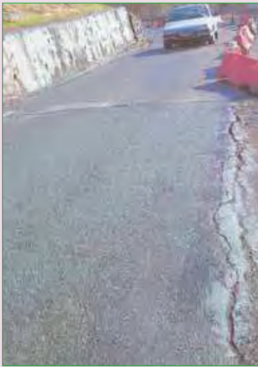
FIGURE 27 - Exemple de fissure longitudinale due à une déformation horizontale excessive.
