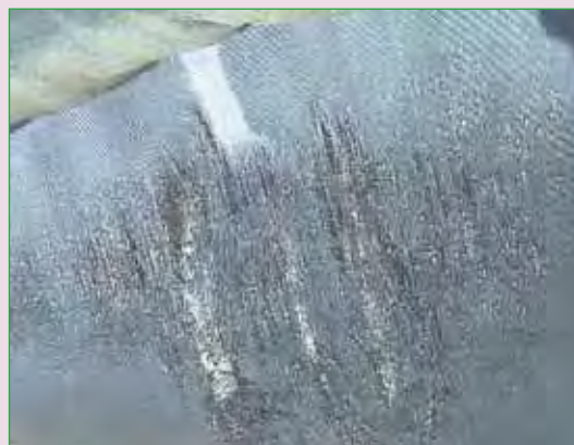
b. Avec dégradation de surface.
