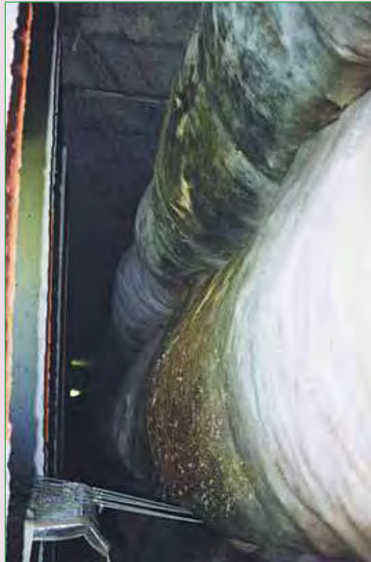
FIGURE 28 - Venues d'eau le long des nappes, visibles en parement.
