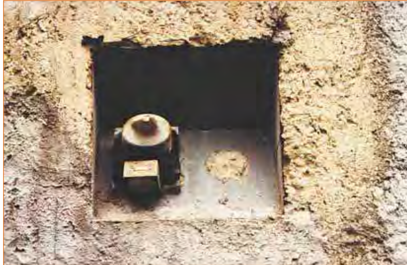
FIGURE 9 - Tirant d'ancrage dans une réservation de paroi, équipé d'un dispositif de contrôle de la tension. (Remarquer la réservation pour tirant complémentaire éventuel).
