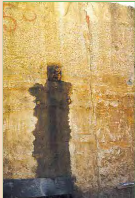
FIGURE 12 - Défaut d'exécution de la protection de la tête d'un tirant.
