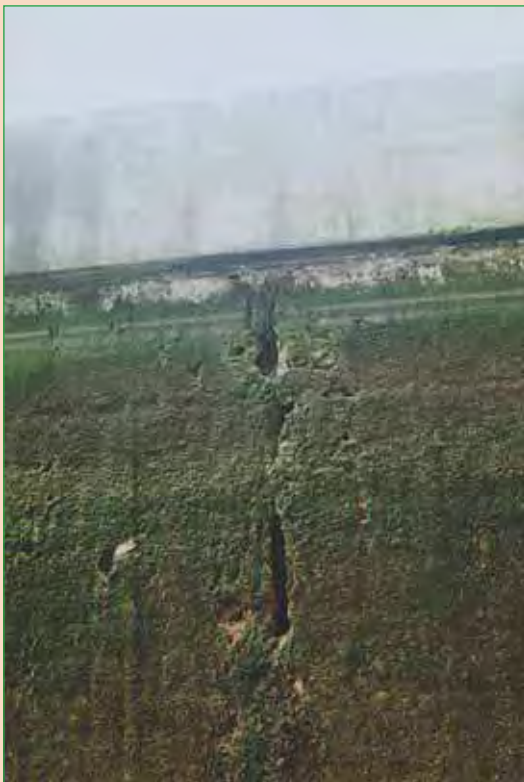
FIGURE 11 - Mauvaise exécution d'un joint.
