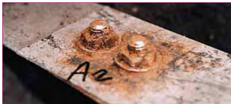
FIGURE 35 - Corrosion de la boulonnerie d'attache au parement.
