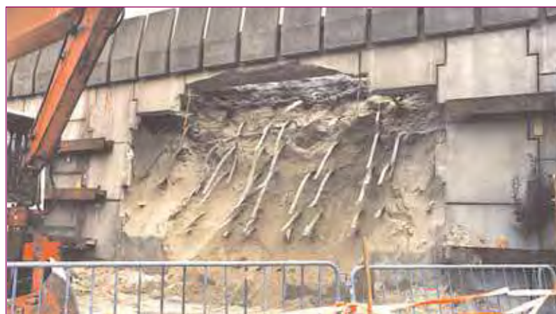
FIGURE 26 - Rupture brutale d'un ouvrage sans signes précurseurs.
