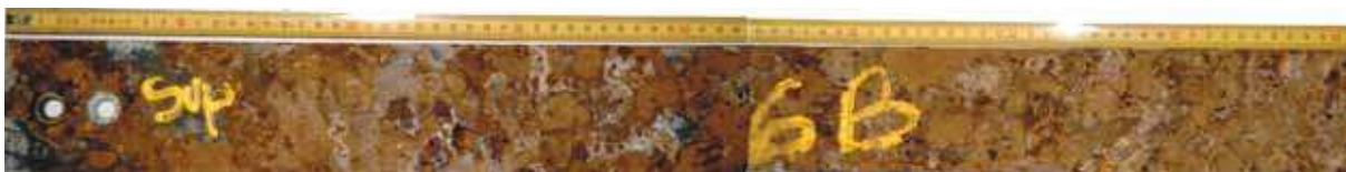
FIGURE 34 - Corrosion uniforme d'une armature en acier galvanisé.
