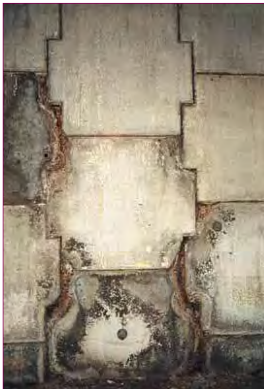
FIGURE 17 - Dégradation du béton d'une écaïlle par réaction sulfatique externe.
