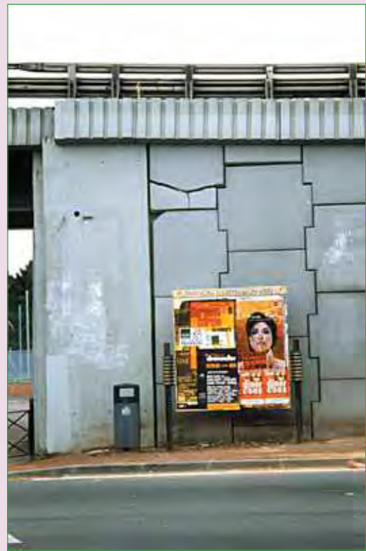
b. avec fracturation du parement.
