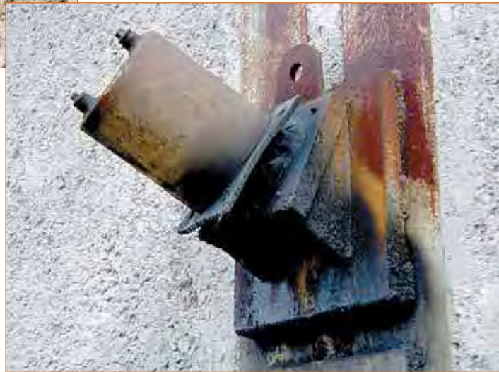
FIGURE 10 - Tête de tirant détériorée par un choc de camion.
