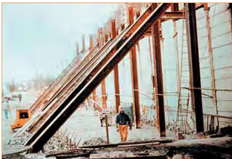
FIGURE 8 - Paroi Berlinoise instable, confortée en cours de travaux.
