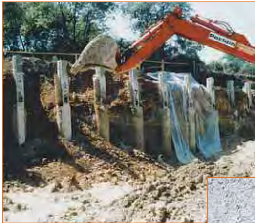
FIGURE 9 - Hors-profil importants lors de l'excavation.
