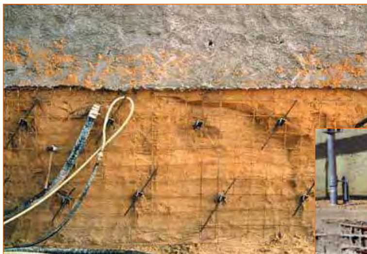
FIGURE 7 - Détail de têtes de clou, cas des cornières battues.
