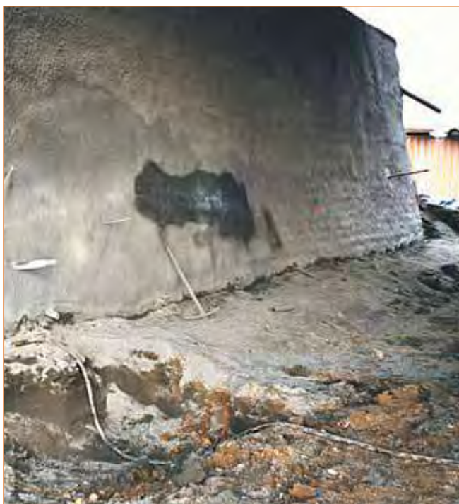
FIGURE 14 - Défaut de drainage.
