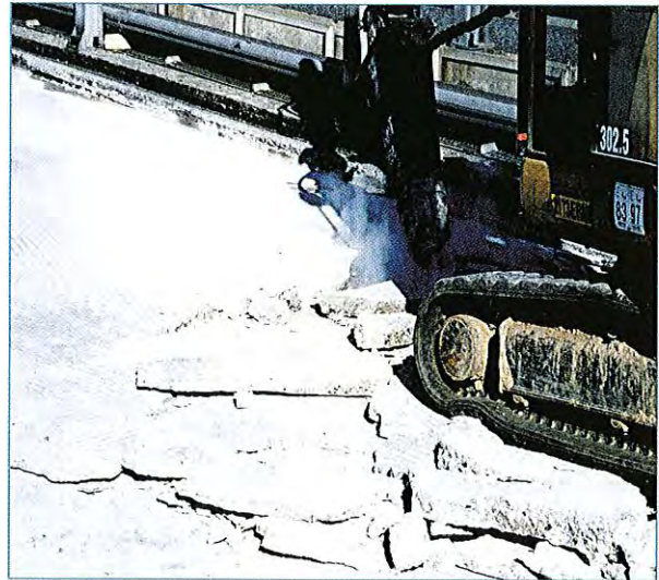
Démolition de renformis béton au BRH (à proscrire)
