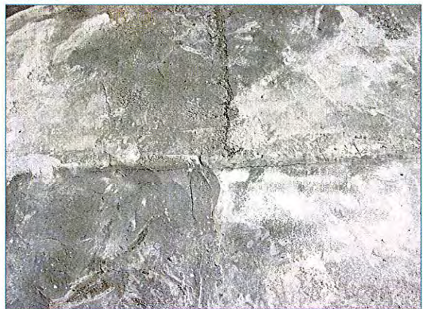
Fissure dans joint sec et aspect grenu au droit du raccord
