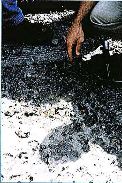
Essai d'hydrodémolition du renformis ; il s'ensuit une forte dégradation superficielle du tablier
