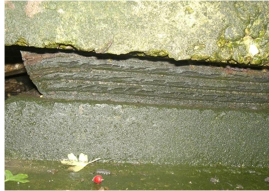
Distorsion des appareils d'appui
