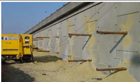
Tube de réservation débouchant du côté opposé au point d'impact du forage
