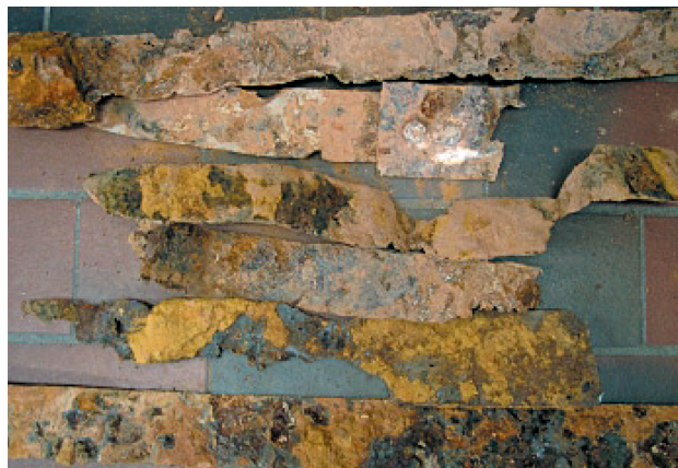
Photo 11. Armatures lisses en bande en acier galvanisé selon le procédé Sendzimir présentant une corrosion très avancée
