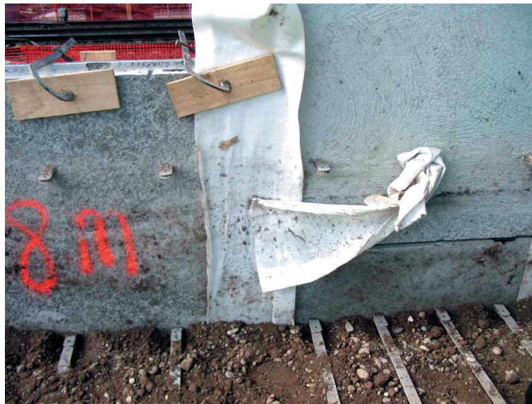
Photo 7. Vue du parement intérieur d'un mur en cours de construction (Photo : CETE de l'Est)
