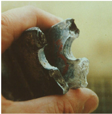
Photo 45. Rupture ductile des armatures au droit des percements
