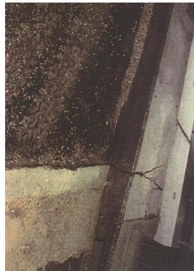
Photo 42. Fracture de la longrine support de BN4
