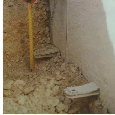
Photo 44. Décalage vertical entre armatures et amorces
