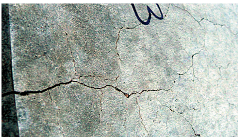
Photo 12. Fissuration et faïençage sur une écaille en béton du parement
