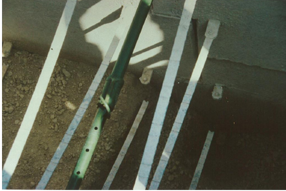
Photo 43. Fouille mettant en évidence les ruptures d'armature
