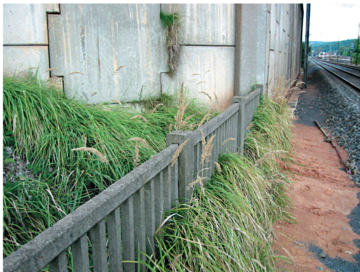
Photo 13. Exemple de fuite de matériau de remblai en pied d'un massif en sol renforcé
