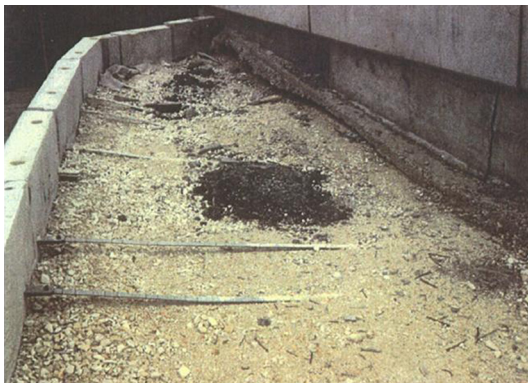
Photo 39. Vide sous la dalle de transition
