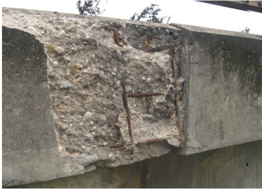
Contact des corniches avec épaufrures
