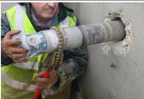
Tricône débouchant du côté de la rampe opposé au point d'impact des forages, noter la dégradation de l'écaille
