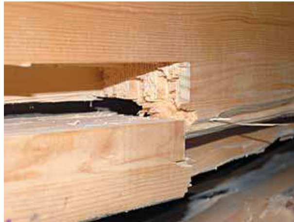
Figure 34 - Rupture complète par perte de section résistante.
