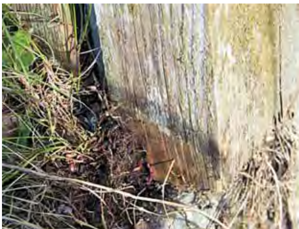
Figure 44 - Accroissement de la végétation.
