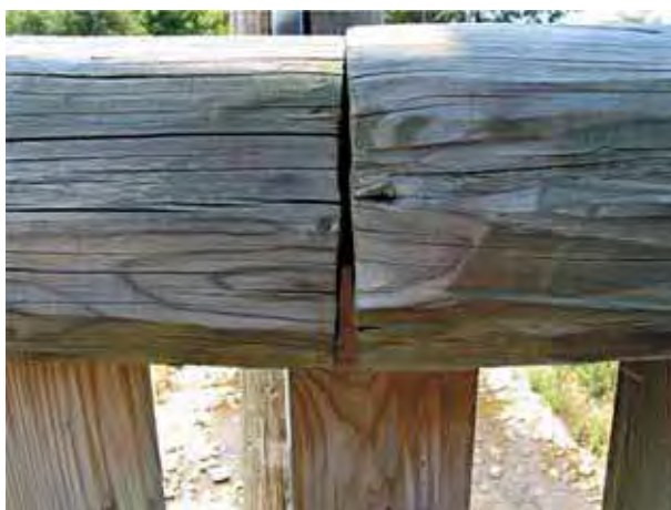
Figure 63 - Désalignement de lisses d'une main courante.
