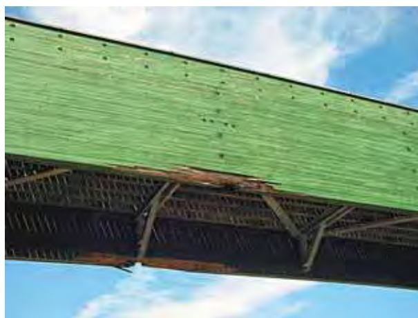
Figure 62 - Perte de section d'une poutre suite à un choc de PL.
