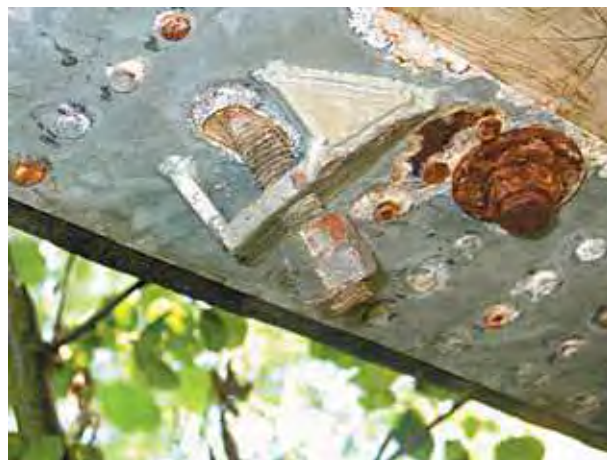
Figure 66 - Oxydation d'organes métalliques.
