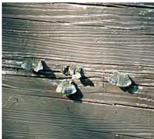
Figure 53 - Champignons apparents témoins de dégradation avancée.
