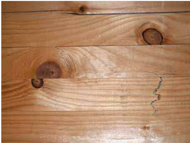
Figure 32 - Rupture initiale en traction et fissures à proximité d'un nœud.
