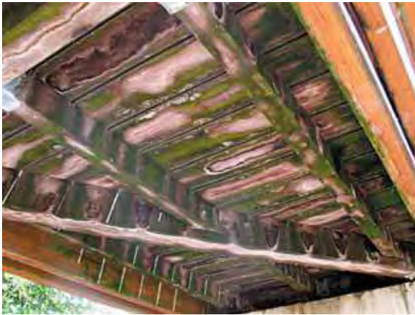
Figure 54 - Zones sombres témoins d'humidification localement élevée. La mousse verte est un lichen.
