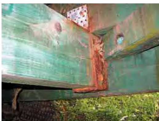
Figure 47 - Corrosion de la ferrure et fente de retrait de l'entretoise due à un retrait empêché.
