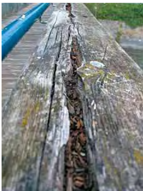
Figure 36 - Surface de bois non protégée : fentes de retrait, infiltration d'eau, développement fongique.
