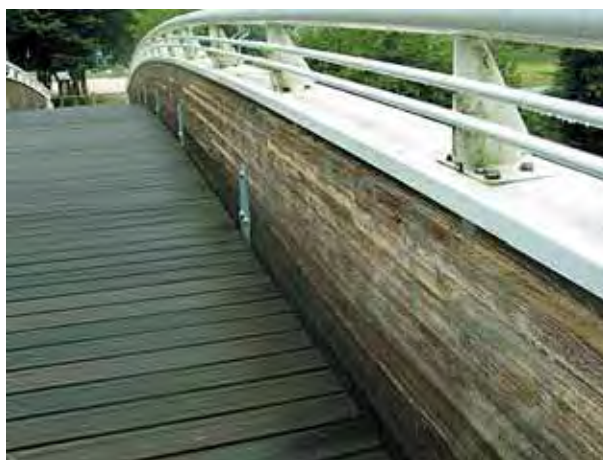
Figure 74 - Dégradation des lasures.
