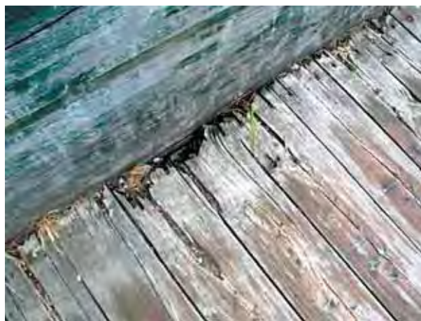
Figure 42 - Zone de mauvaise ventilation entraînant la dégradation du bois.
