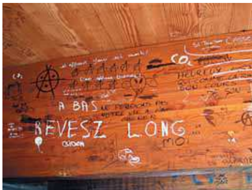
Figure 50 - Vandalisme : Présence de graffitis.
