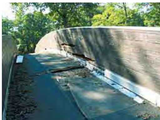
Figure 38 - Zones pourries conséquentes induisant la fermeture de la passerelle.
