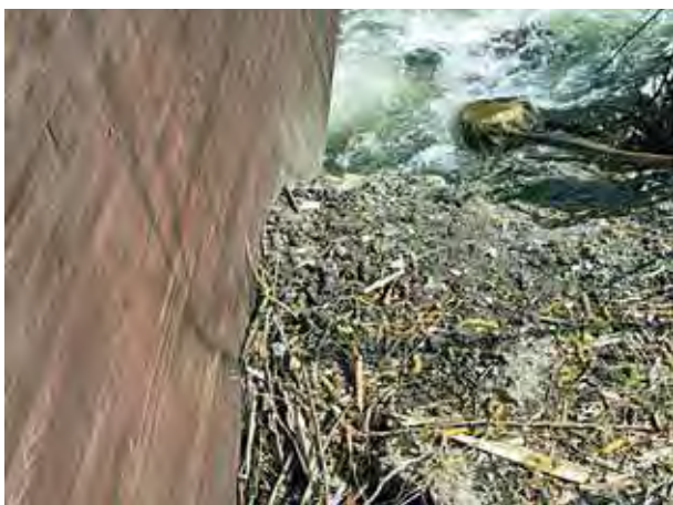
Figure 43 - Accumulation de terre au contact du bois.
