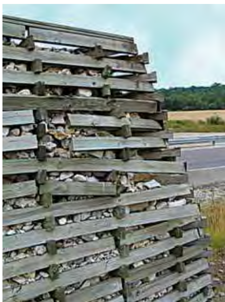
Figure 22 - Désorganisation d'un mur de soutènement
