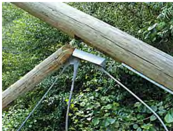
Figure 68 - Rupture d'un assemblage.
