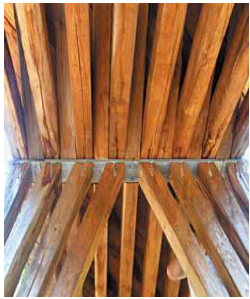
Figure 16 - Bois fendu sous chaussée.
