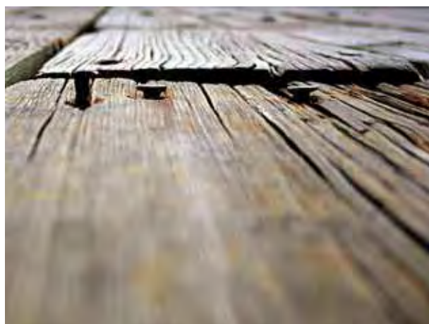
Figure 24 - Déclouement du platelage suite aux vibrations.
