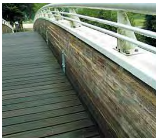
Figure 51 - Dégradation d'une lasure par farinage.
