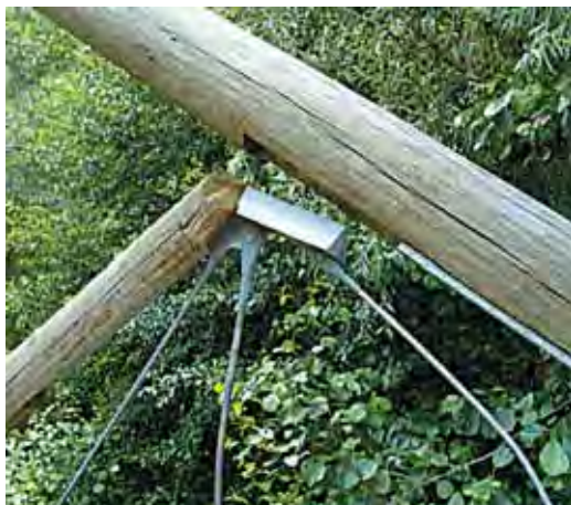
Figure 21 - Rupture d'un assemblage.
