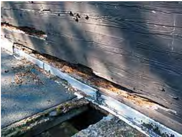
Figure 39 - Zones pourries allant jusqu'à la ruine du platelage (détail de la photo 38).
