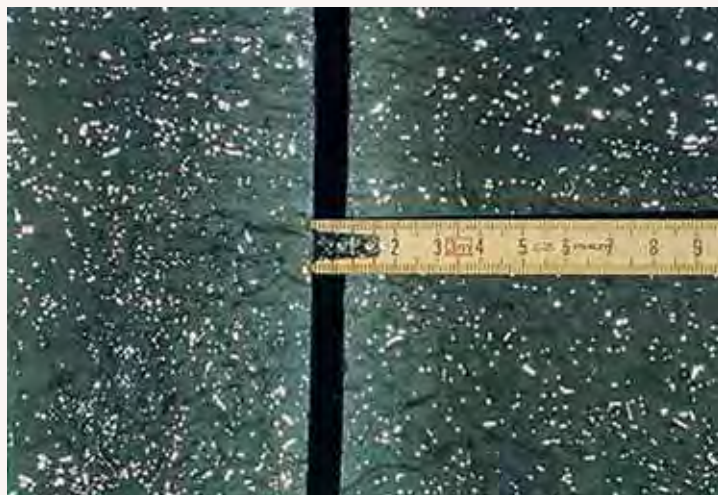
Exemple de saignée sur un barrage.
