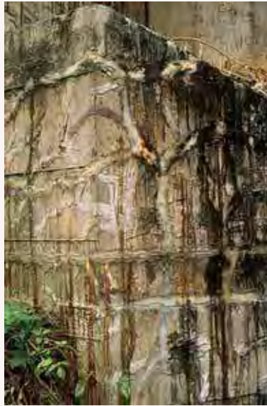
Fig. 1 – Réouverture d'une fissure sur un ouvrage situé en Afrique équatoriale.
