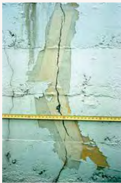
Fig. 4 – Pont suspendu : réapparition d'une fissure d'alcali-réaction injectée et cachetée quelques années auparavant.
