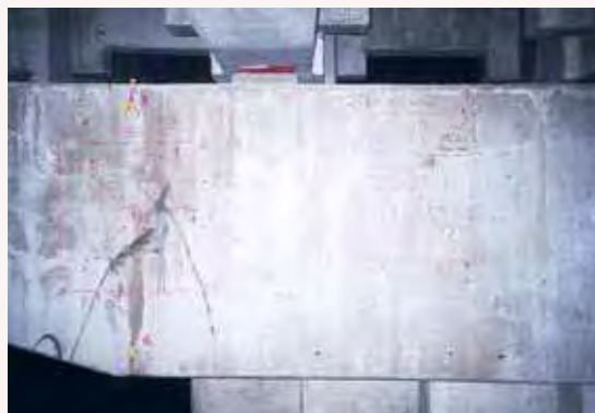
Zone vitale atteinte (chevêtre de pile marteau) par des désordres intenses (réseau de fissures).
