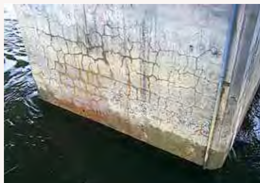
Zone vitale atteinte (pile) par des désordres intenses (réseau de fissures de plus de 0,3 mm d'ouverture) avec situation aggravée par la présence d'eau.
