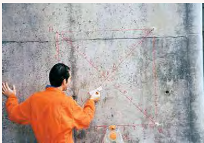
Mesure de l'indice de fissuration.
