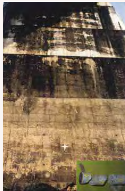
Fig 1 – Dégradations dues à l'alcali-réaction.
