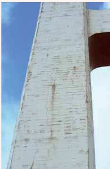
Fig. 3 – Pont suspendu : fissuration verticale d'une jambe de pylône.
