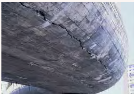
Zone vitale atteinte (dalle de tablier) par des désordres très intenses (présence d'une fracture et béton très dégradé).
