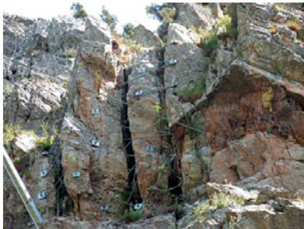
Figure SC2.2 Câblage d'une colonne – Tende (Gard)
