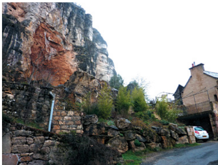
Figure Cas1.3 Vue de la zone débarrassée des éboulis, en 2013 : on distingue la cicatrice de teinte ocre sur la falaise
