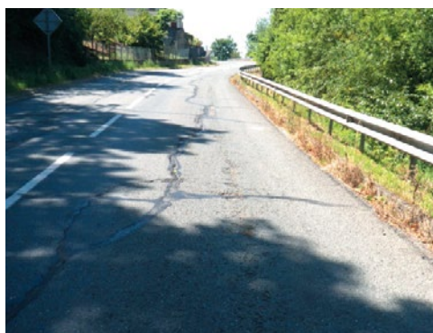
Figure Cas1.1 Désordres sur la RN 21, août 2012
