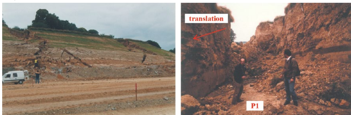
Figure 6 Glissement sur un plan de discontinuité (P1), avec remplissage argileux et venues d'eau, dans des schistes affectant un talus de déblai en phase travaux de l'autoroute A84 à Villedieu-les-Poêles (Manche). À gauche, vue d'ensemble du talus rocheux concerné par l'instabilité. À droite, vue depuis la fracture arrière principale du glissement
