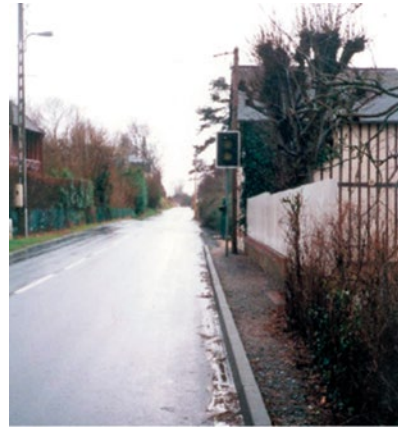
Figure Cas3.2 Feu permettant l'interruption de la circulation sur la RD513 au niveau de la photographie de la figure Cas3.1 en cas de reprise des mouvements d'affaissement de la chaussée
